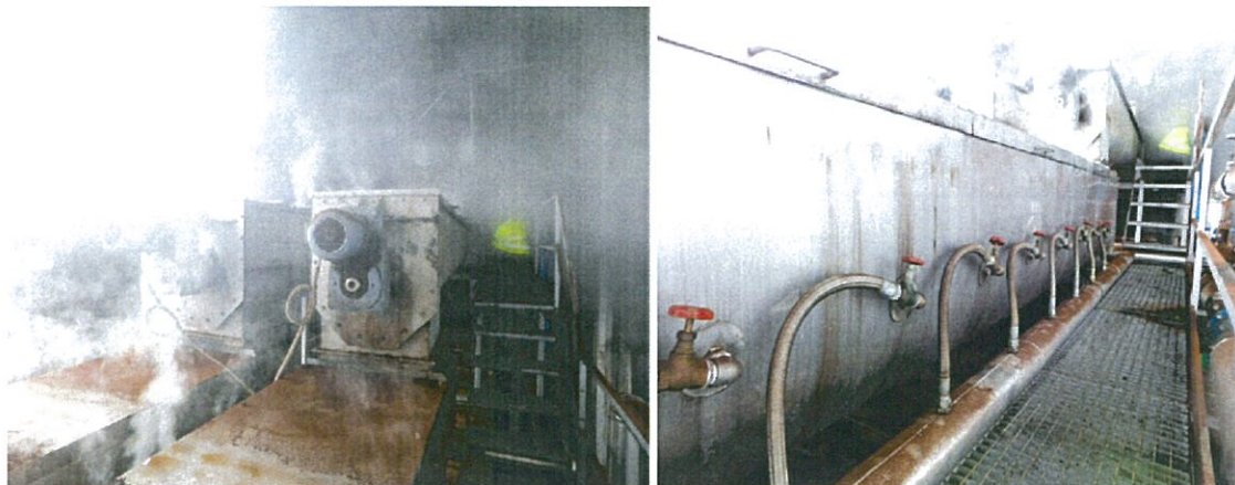
Figura 5 – Sistema de tratamento com injeção de vapor.
